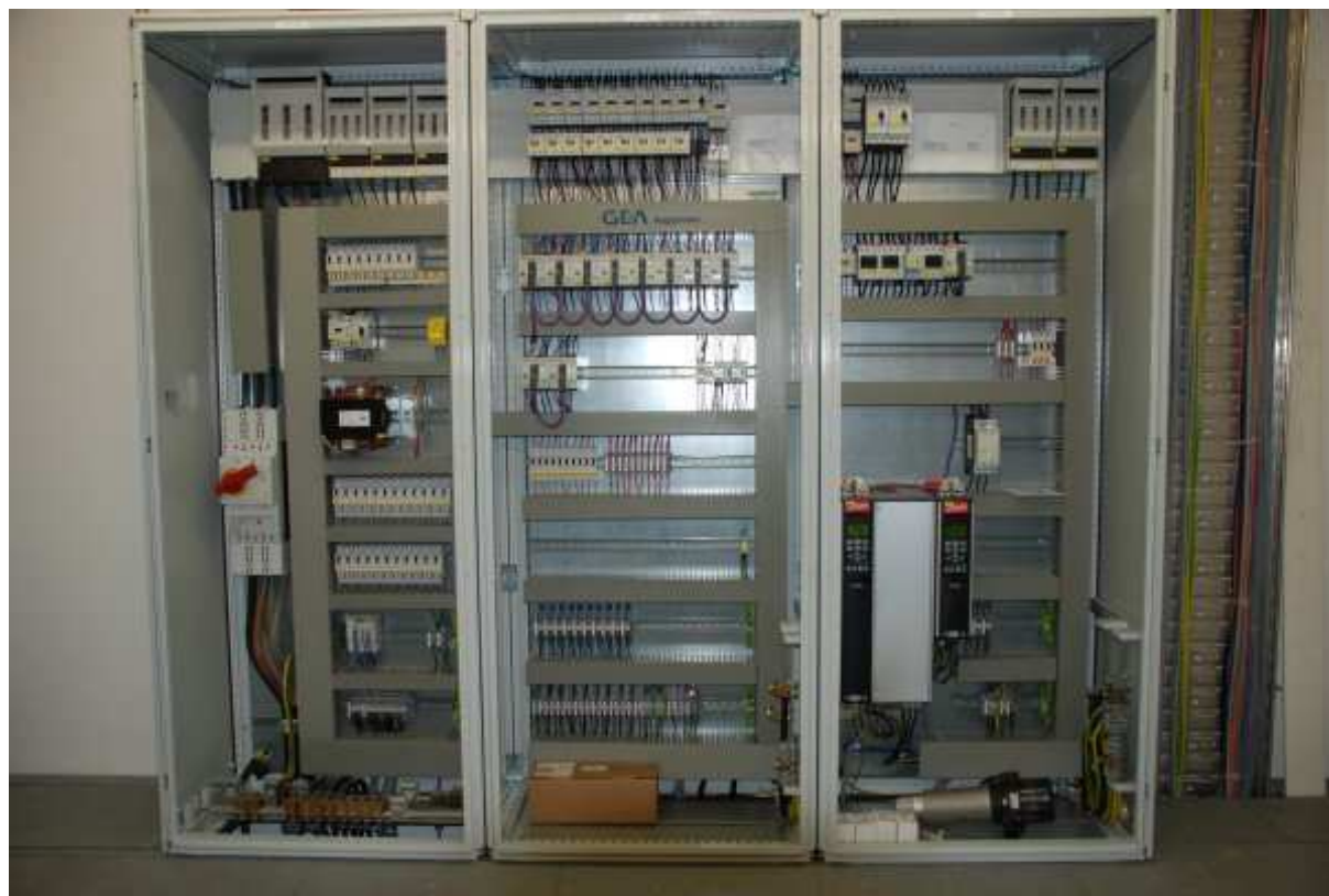
Abb.: Eine Seite im Schalraum Sudhaus nach der Sudhausmodernisierung im Frühjahr 2007
